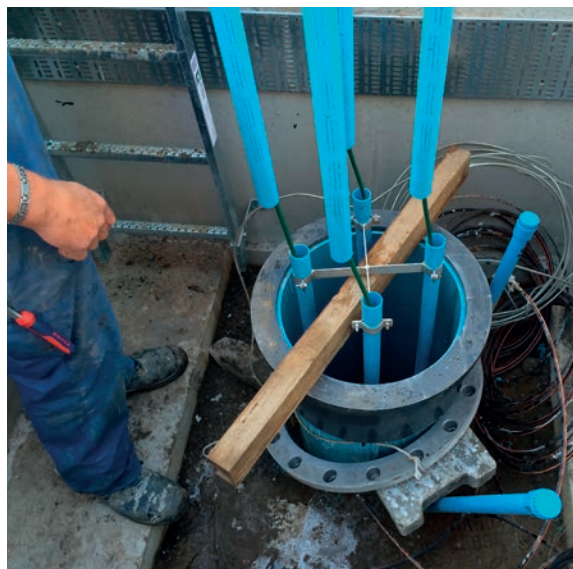
Meetopstelling USP-glasvezelkabel in en aan de buitenzijde van de bronfilter.
